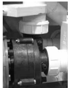
Scheibenventil und Pumpenanschluss
