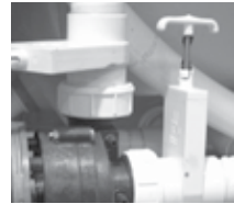
Scheibenventil und Pumpenanschluss
