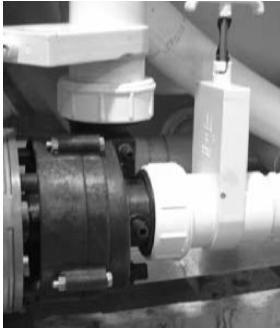
Sperrschieber und Pumpenverschraubung
